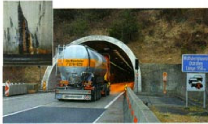
Schlusslicht in Österreich. Der Wolfsbergtunnel auf der A10 bei Spittal ist nicht einmal mehr ganz dicht (Foto links oben) – aber ab Herbst 2008 wird saniert.
