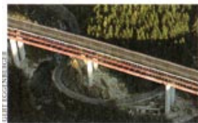
Altersbergbrücke mangelhaft saniert
